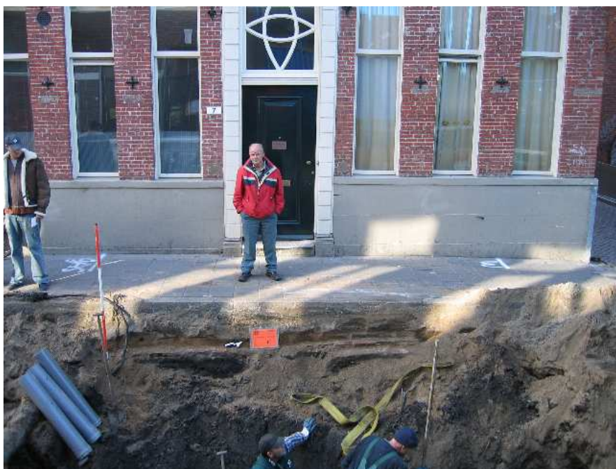
Afbeelding 2.12 Haddingestraat 7. Onder het trottoir de fundering van een brede stoep of opgang. Foto A. Wieringa.
